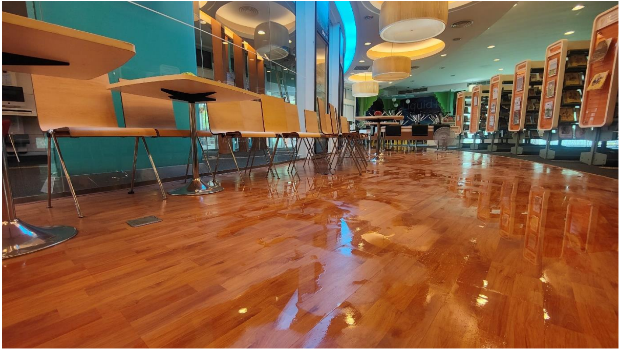
น้ำซังภายในพื้นที่บริการห้องคลังความรู้ ปลั๊กฝังพื้น แชนน้ำ จำนวน 4 จุด
